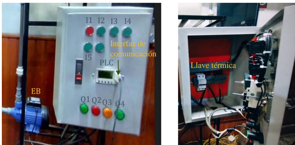
Figura 26. Imagen real de algunos componentes del sistema de control.
