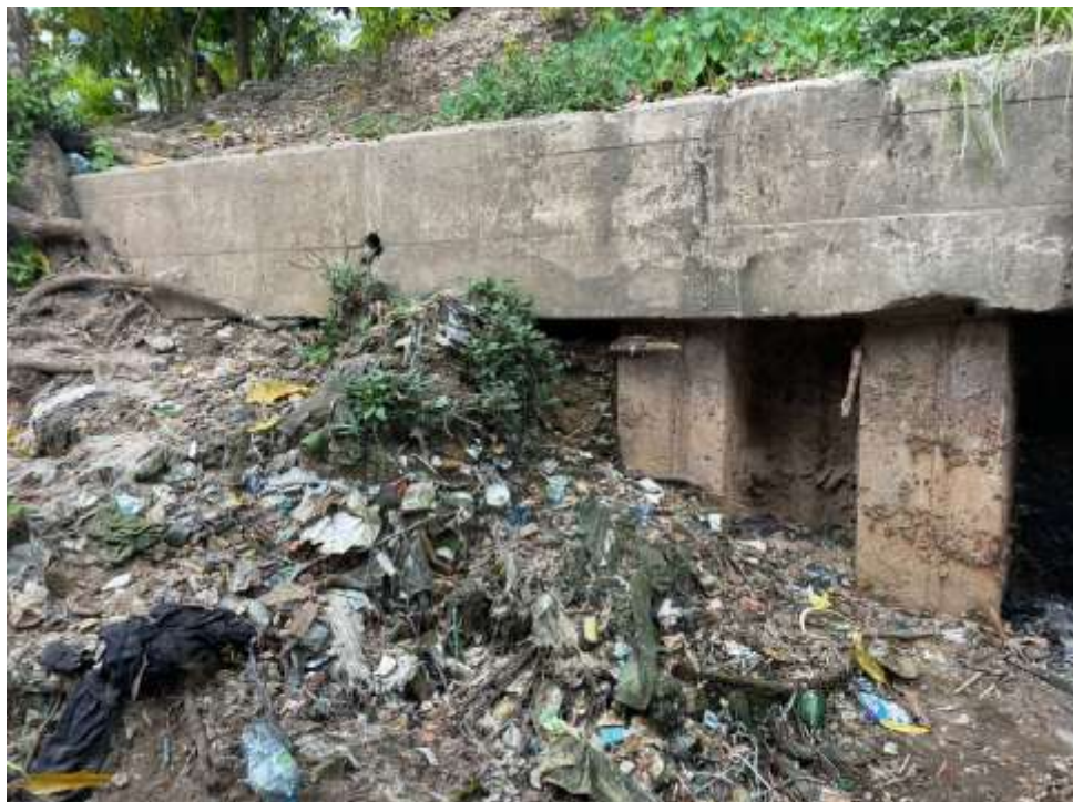
Fotografía (4) de los procesos: erosión y desestabilización del suelo. (Toma de imagen en Octubre 2022).
