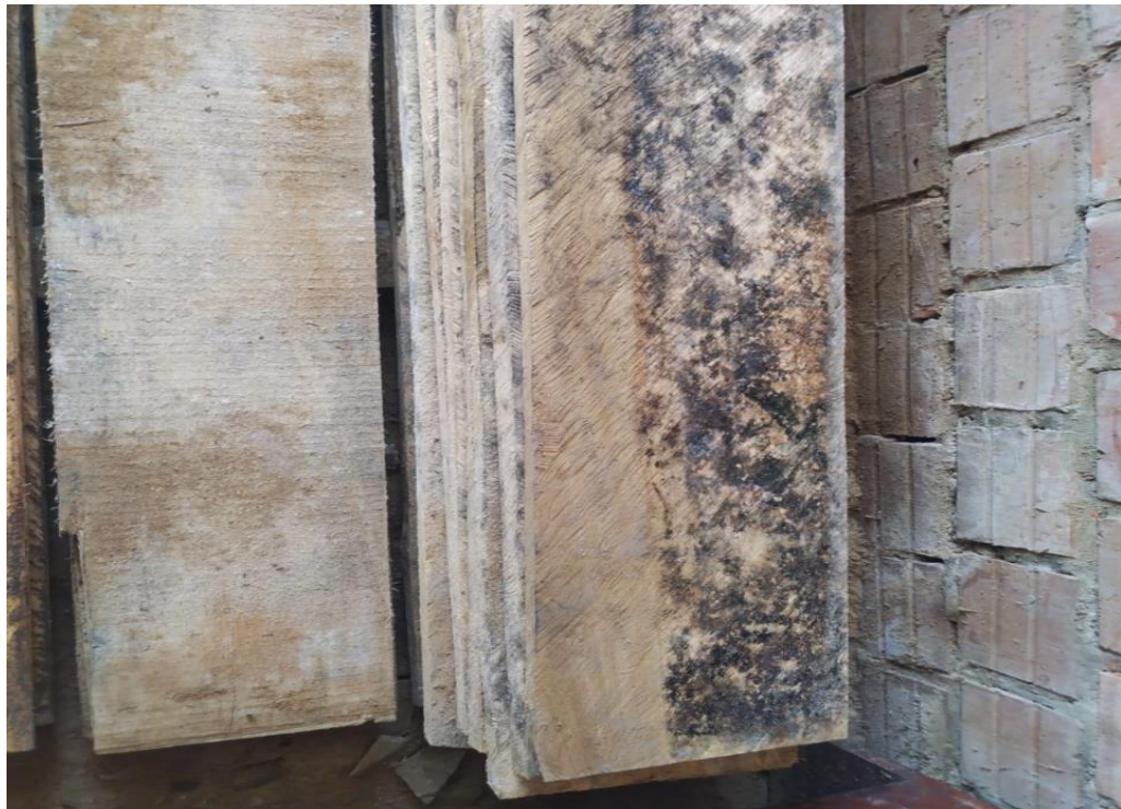
Figura 08: Presencia de hongo negro y faltante de madera en los extremos
