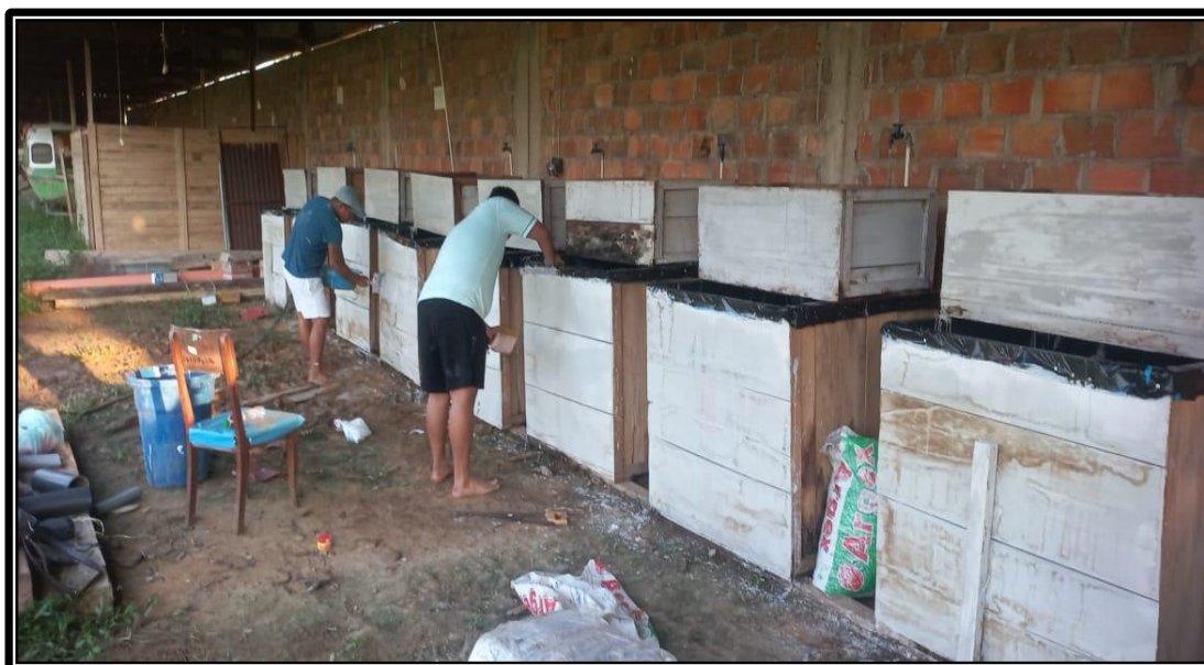
Foto 3. Instalación y acondicionamiento del sistema acuapónico.
