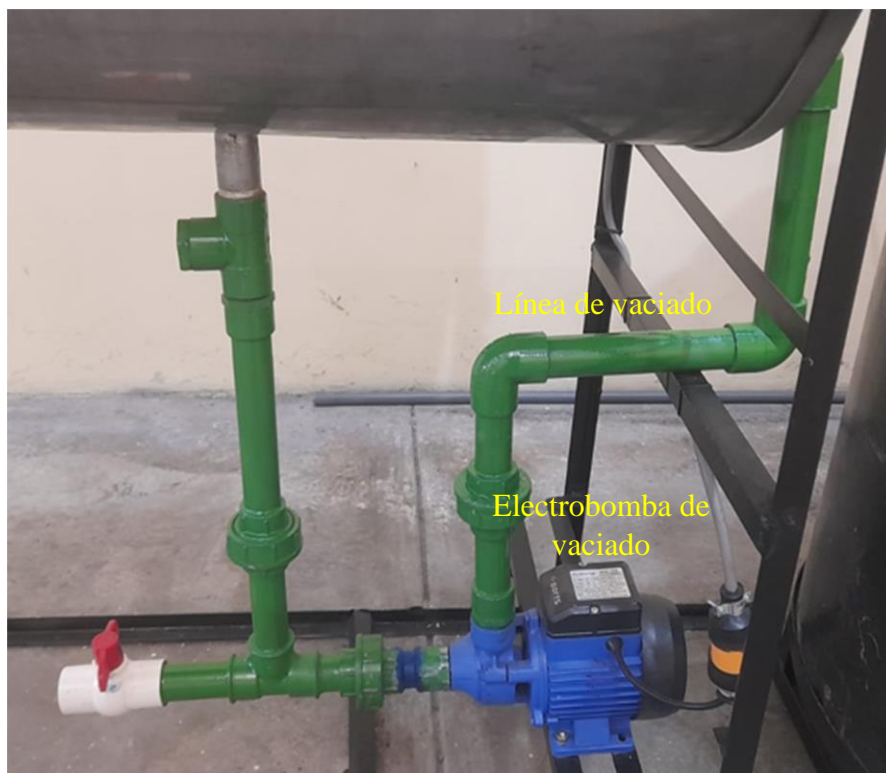
Figura 20. Vistas reales de las líneas de vaciado y llenado.
