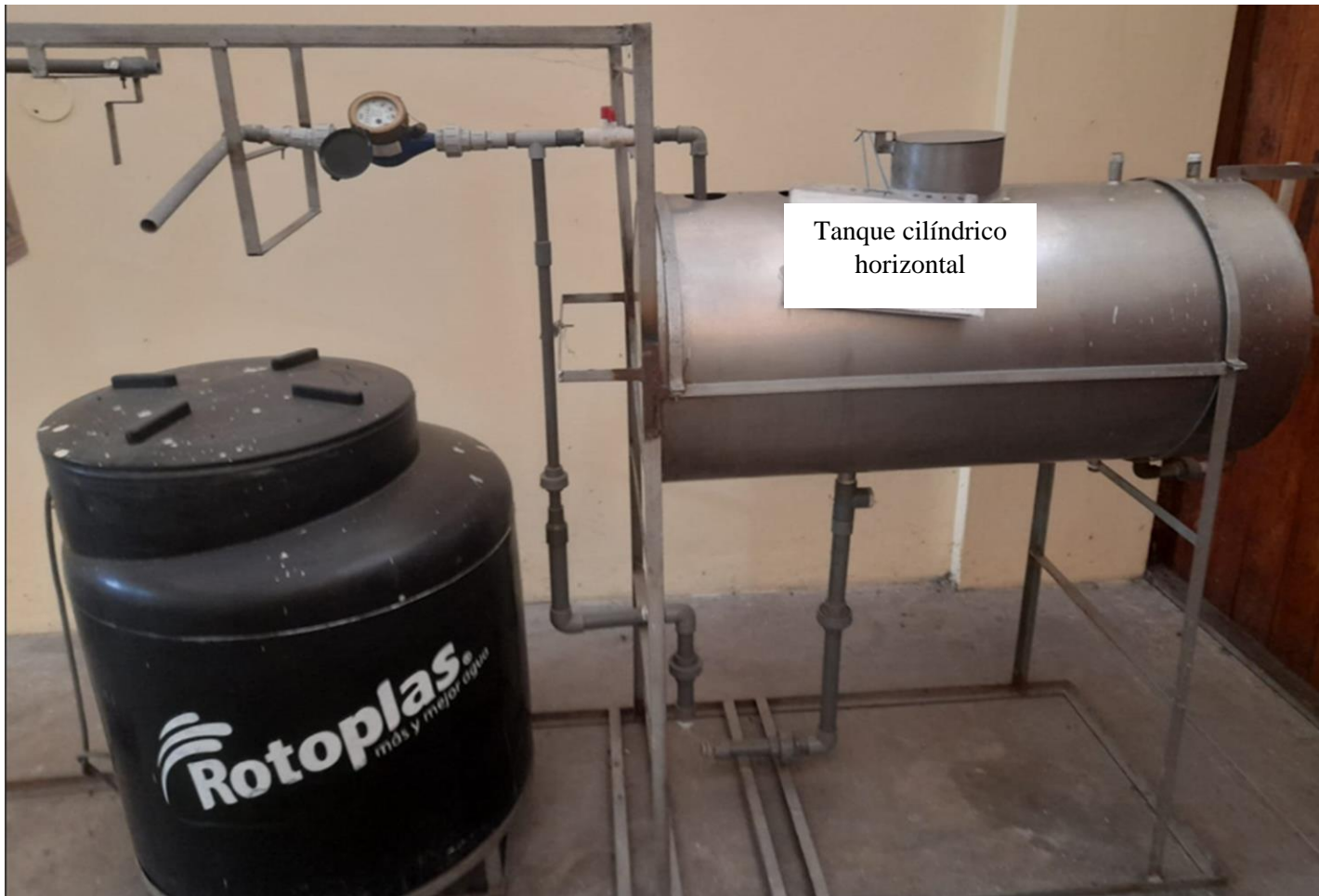
Figura 12. Tanque cilíndrico horizontal antes de la implementación del sistema automatizado.
