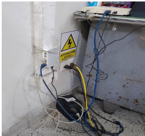
Figura 11. Enchufes sobrecargados y cables expuestos
