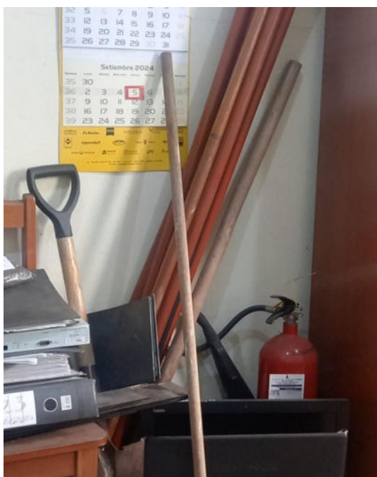
Figura 13. Extintor guardado junto a material combustible en oficina de asuntos económicos.
