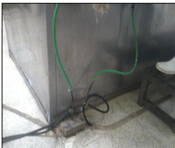
Imagen 03. Instalaciones eléctricas expuestas constituyendo riesgos al personal, así como a los comensales en caso de descargas eléctricas.
