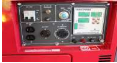
FIGURA 03. GENERADOR DE LUZ
