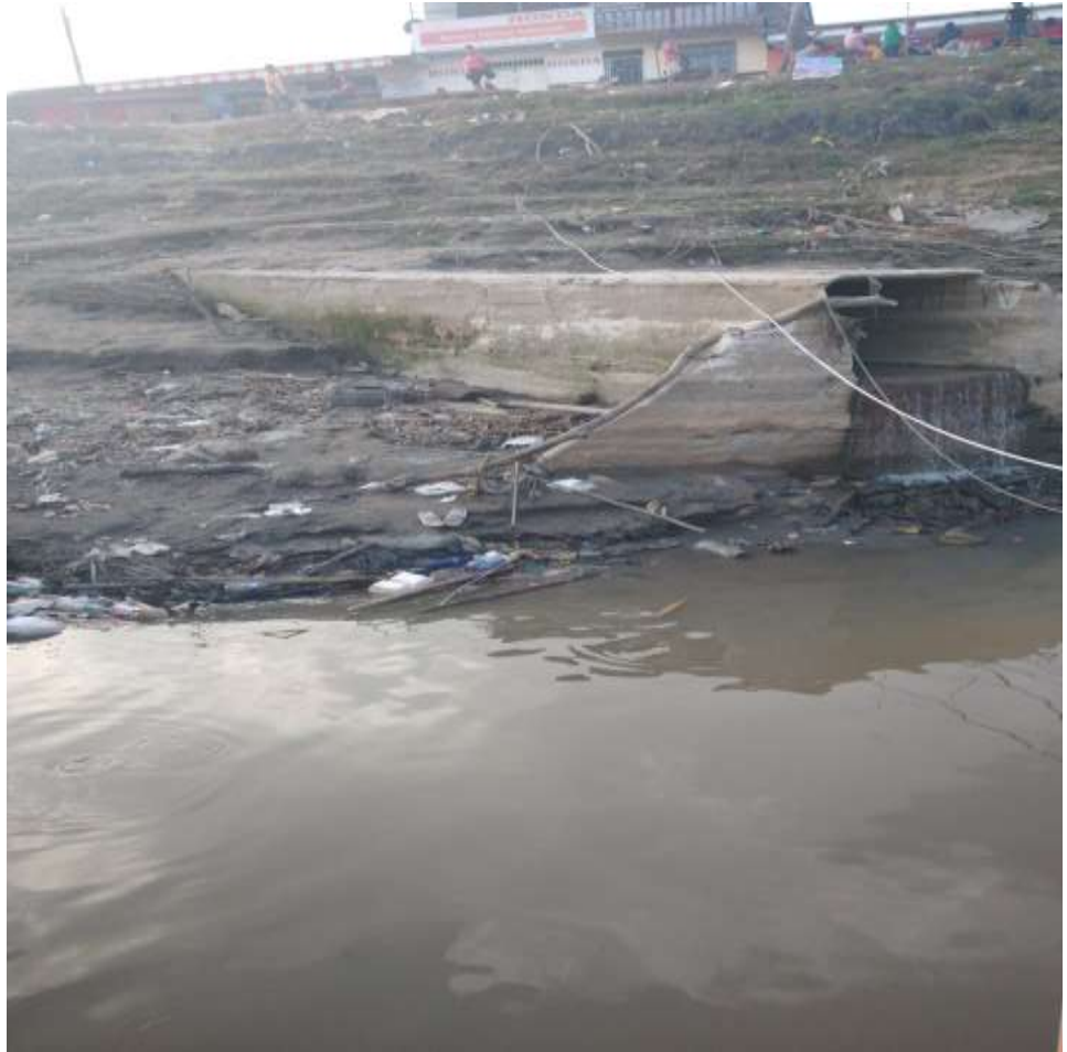
Foto 1. Contaminación aguas servidas al río Marañón
