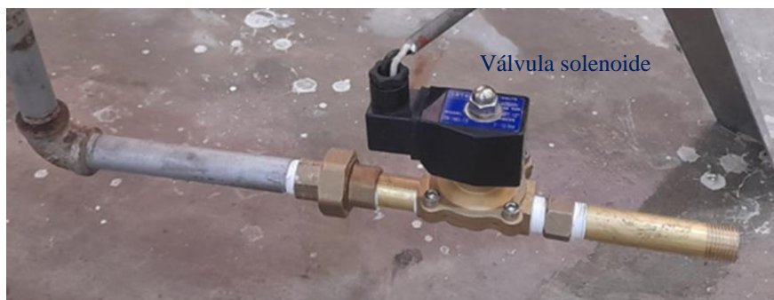
Figura 20. Vistas reales de los componentes principales del sistema automatizado.
